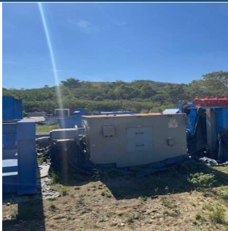
Figura 12 - Motor elétrico do moinho
