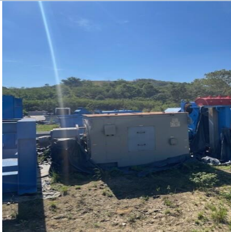
Figura 12 - Motor elétrico do moinho
