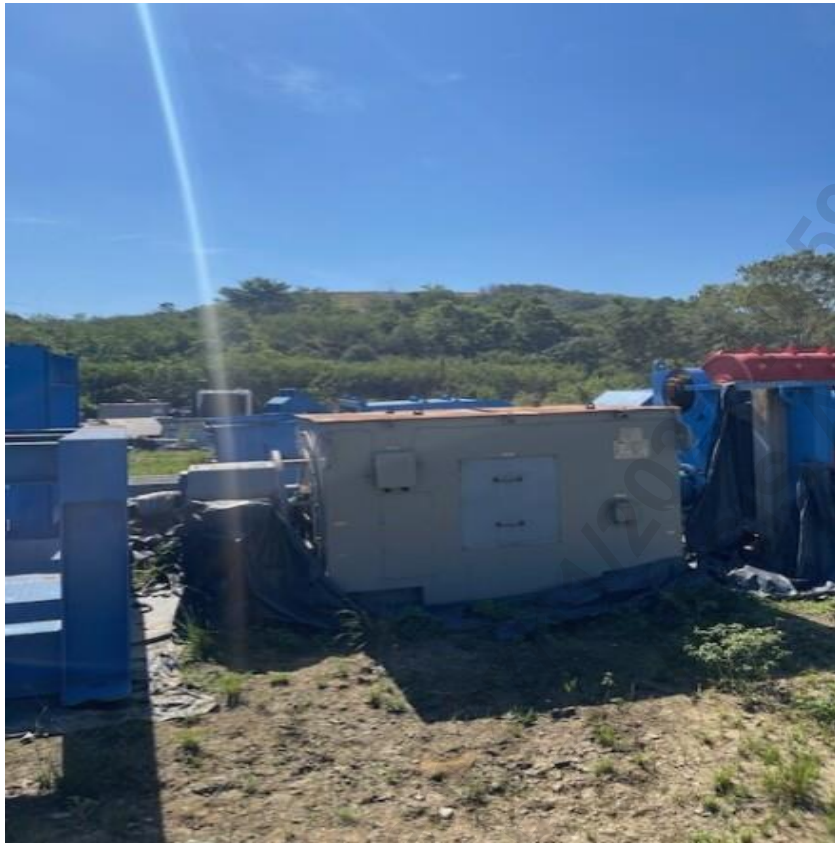
Figura 13 - Motor elétrico do moinho
