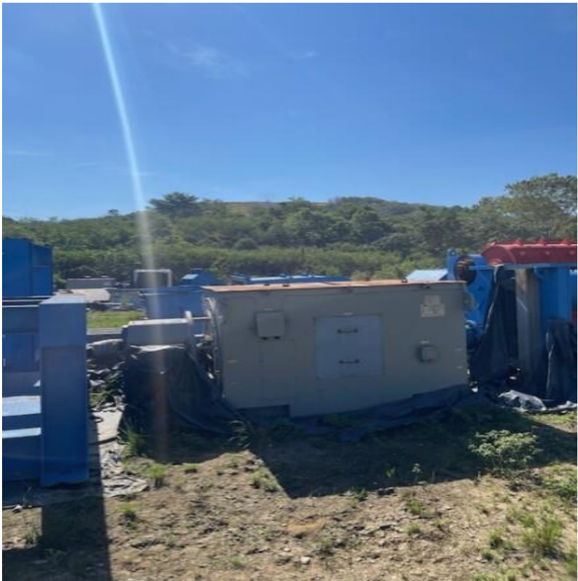
Figura 16 - Motor elétrico do moinho
