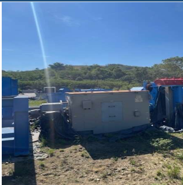
Figura 12 - Motor elétrico do moinho
